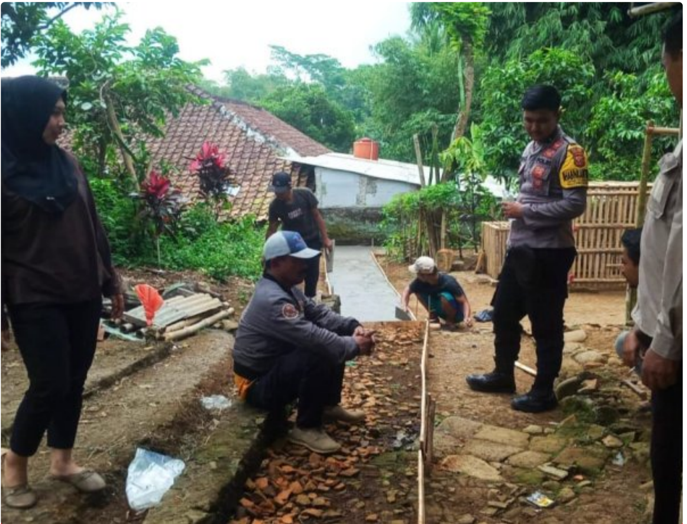
Bripda M. Reza Rizaldi Ajak Warga Kp. Pareang Gotong Royong dalam Rehabilitasi Jalan Lingkungan
