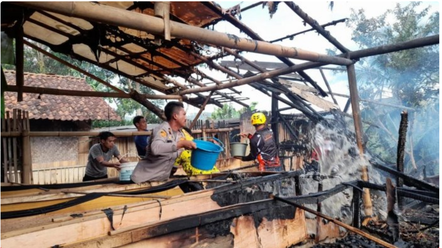
Diduga Korsleting Listrik, Sebuah Rumah di Ciambar Hangus Terbakar, Polisi Langsung Respon Cepat
